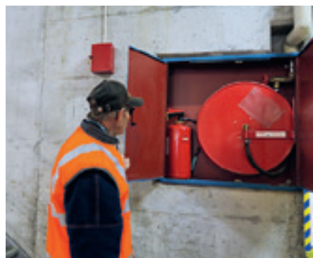
Kontrolle bei einem der Feuerlöschposten in der Güterhalle
