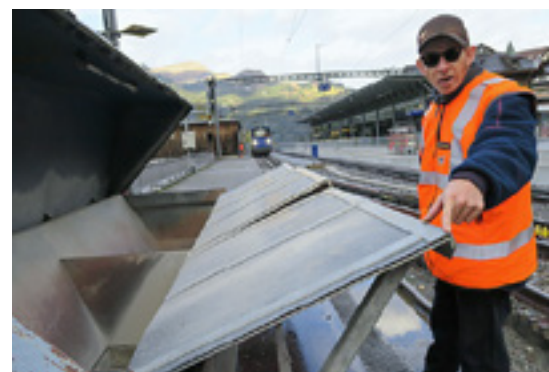
Umladesilos für Schuttgüter beim Gleis 4
