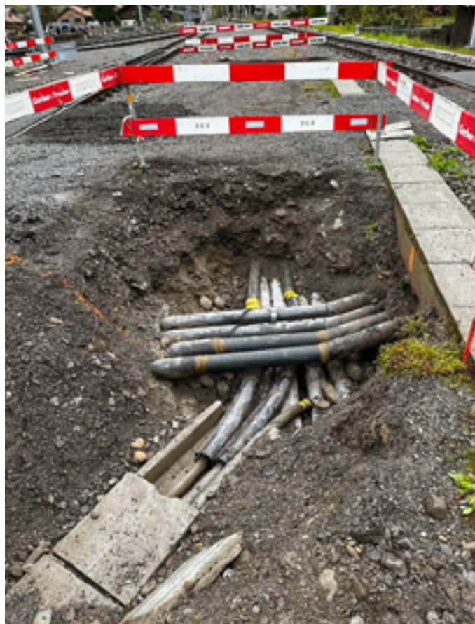
Bestehende bekannte und unbekannte Kabel, bei denen «man» zuerst rausfinden muss, ob sie noch in Betrieb und unter Starkstrom sind
