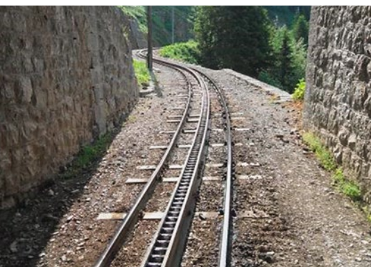
Gleis mit fehlendem Schotter
