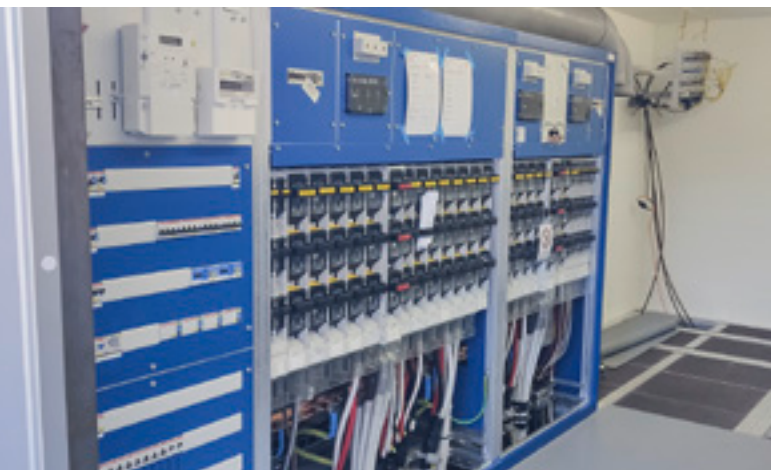
Neue Niederspannungsverteilung Trafostation Alpbach
