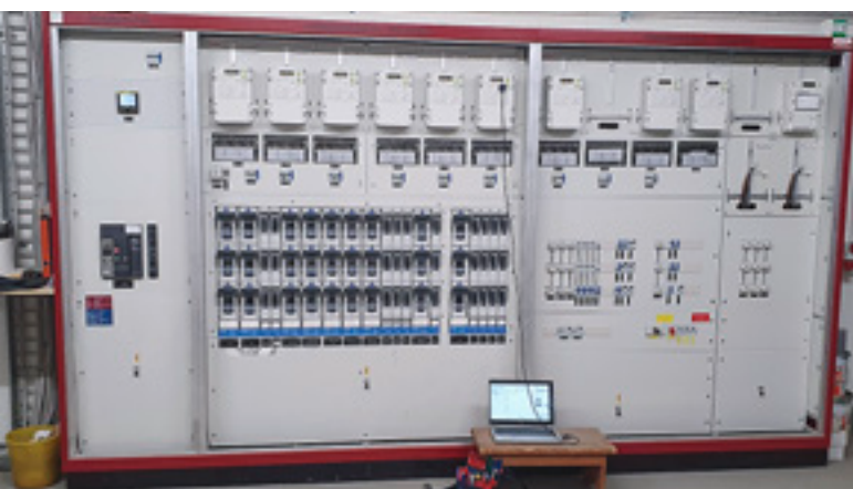
Die Smart Meter müssen vor Inbetriebnahme korrekt parametrisiert und eingestellt werden
