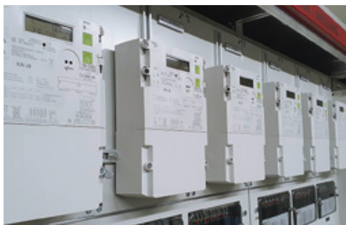
Neue Smart Meter in der Trafostation Wengernalp
