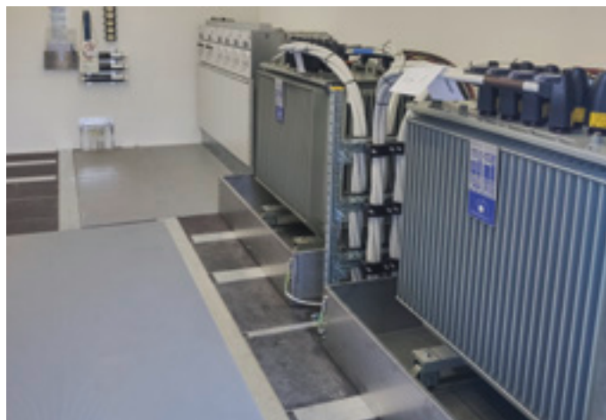
Trafos und Mittelspannungsschaltanlage in der neu umgebauten Trafostation Alpbach
