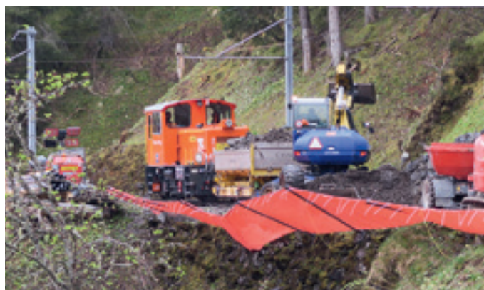
Eine der beiden Lokomotiven (2-achsig, je 24 t)
