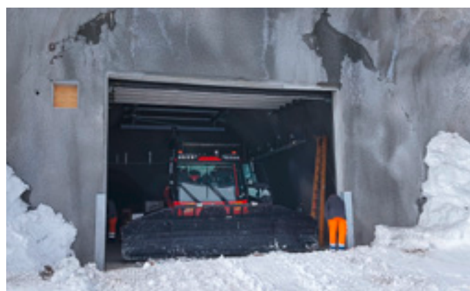
Pistenbully in der neuen Garage
