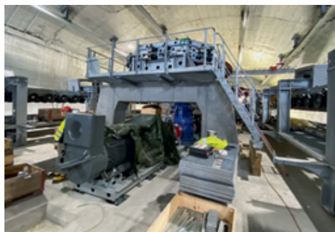
Antrieb und Motoren in der Bergstation der 3S-Bahn Eiger Express
