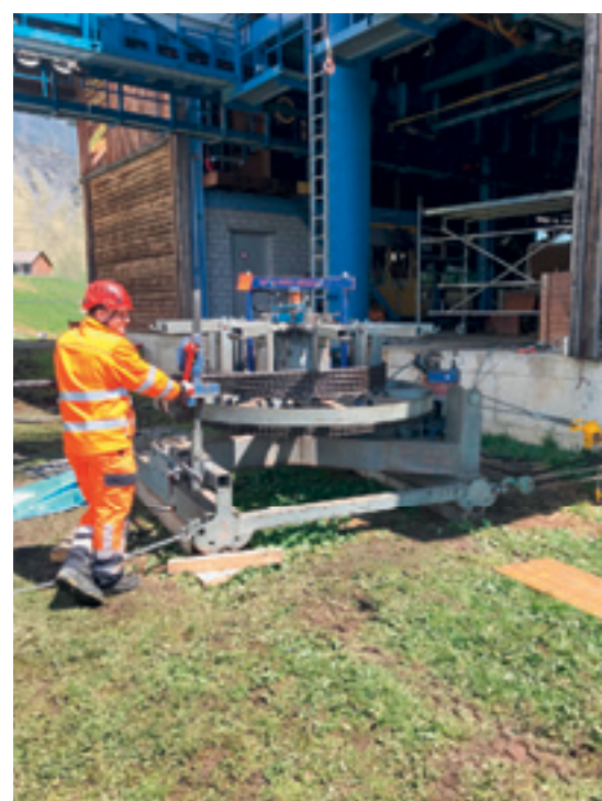
Seilersatz 3. Sektion Firstbahn
