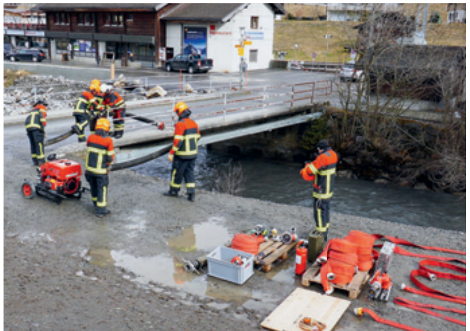
Das Löschwasser wird der Lutschine entnommen
