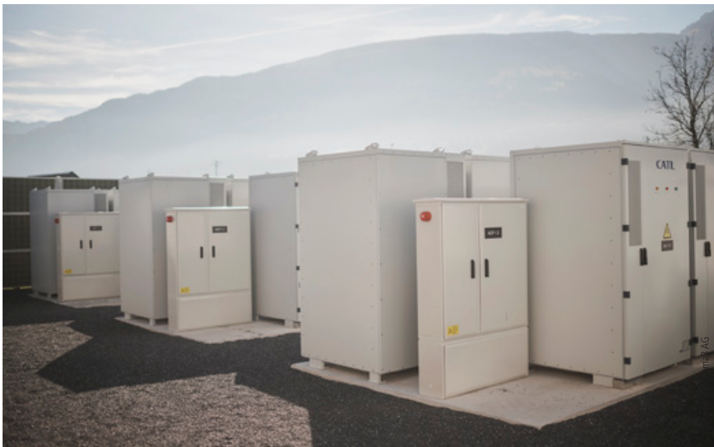
Dieses Bild zeigt einen Anlagenteil einer bereits gebauten Anlage in der Schweiz
